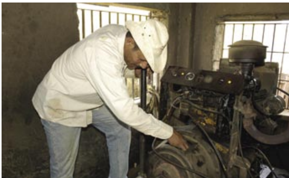
Motorn som driver pumpen är trasig och pengar saknas för att laga den.
